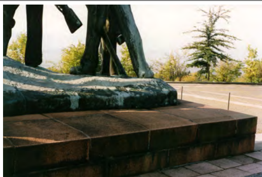
vor der Instandsetzung
