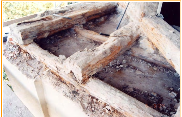
Schäden an Mauerbalken, Deckenbalken, Schwellen
